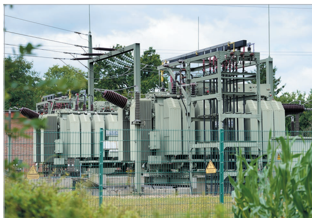
Рис. 1. Одинадцять підстанцій у регіоні Емшер-Ліппе необхідно було обладнати новітніми системами зв'язку та управління
