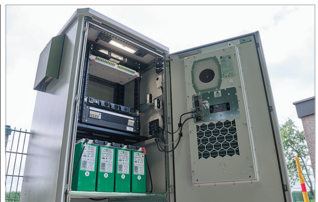
Рис. 4. Проєкт EVNG, зберігання енергії. Зовнішня шафа Rittal outdoor з кліматичним обладнанням для зовнішньої установки
