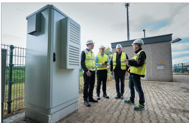
Рис. 3. Проєкт EVNG, зберігання енергії. Зовнішня шафа Rittal outdoor з кліматичним обладнанням для зовнішньої установки
